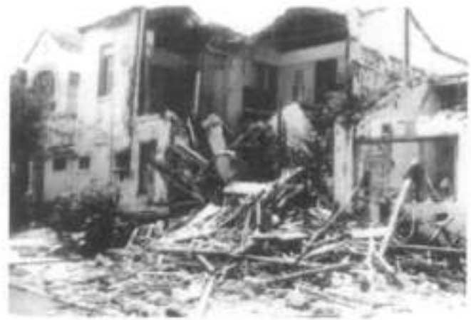
FIGURA 73 - Destroços do Restaurante Estoril, ruído em abril de 1994, em razão das fortes chuvas daquele mês. (Fonte: Mais, 1995, p. 12)
