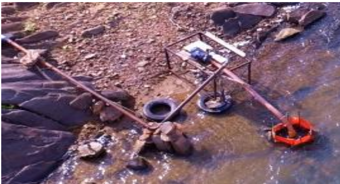
Figura 35 - Bomba de captação de água para o consumo humano
