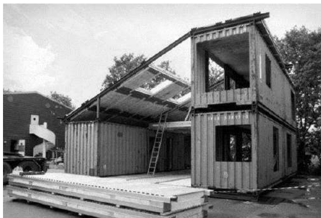
Figura 41 | Aspecto visual original Fonte: Lubrimatic (2017)
