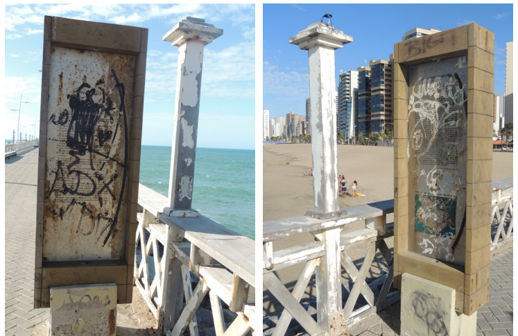
Imagens 90 e 91 - Pichações e falta de conservação das placas explicativas e da própria estrutura do Espigão. Fonte: Acervo pessoal.
