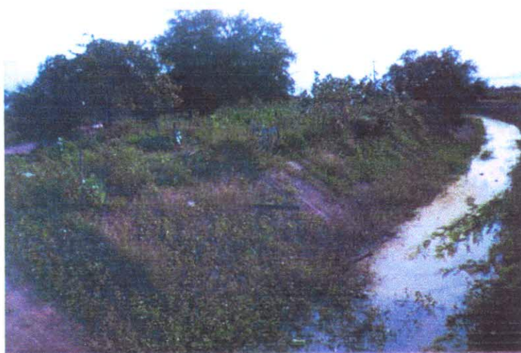
FIGURA 21 – Canal Principal Assoreado do Perímetro de Irrigação de Morada Nova – CE, 2002
