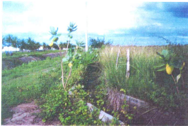
FIGURA 22 – Detalhe do Canal Secundário, que Hoje se Encontra Cheio de Mato e Lama do Perímetro de Irrigação de Morada Nova – CE, 2002
