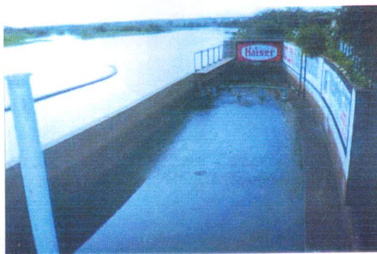
FIGURA 7 – Atual Situação do Canal de Adução do Perímetro de Irrigação de Morada Nova-CE, 2002
