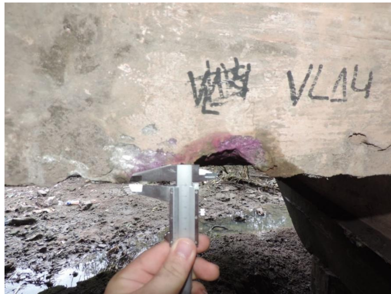
Figura 20 - Ensaio de profundidade de carbonatação V107
