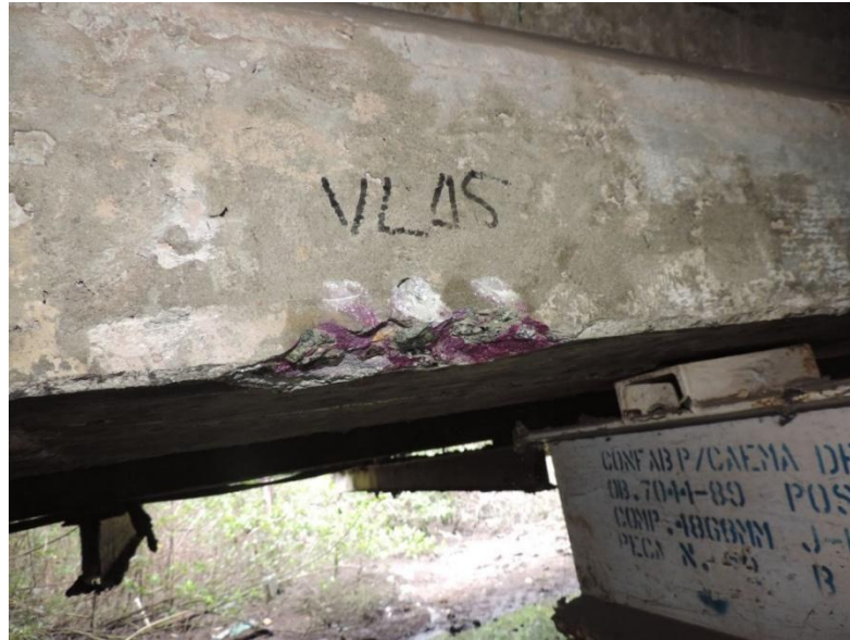
Figura 19 - Ensaio de profundidade de carbonatação V106
