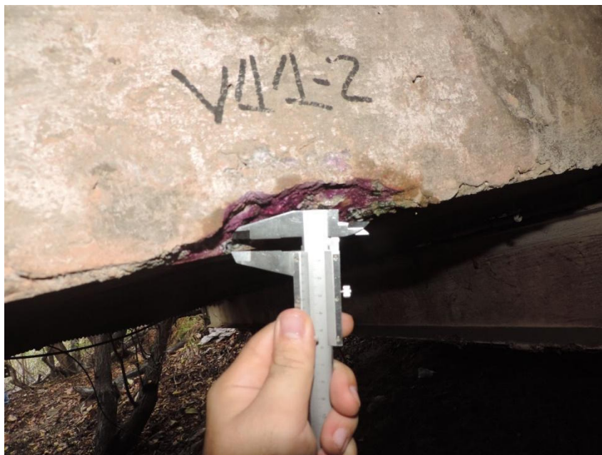
Figura 22 - Ensaio de profundidade de carbonatação V110-2
