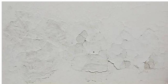
Figura 33 - Pannel P19 com presença de fissuração superficial
