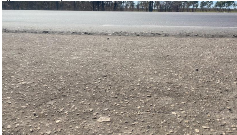
Figura 25: Transição entre a via e o acostamento do trecho do km 61
