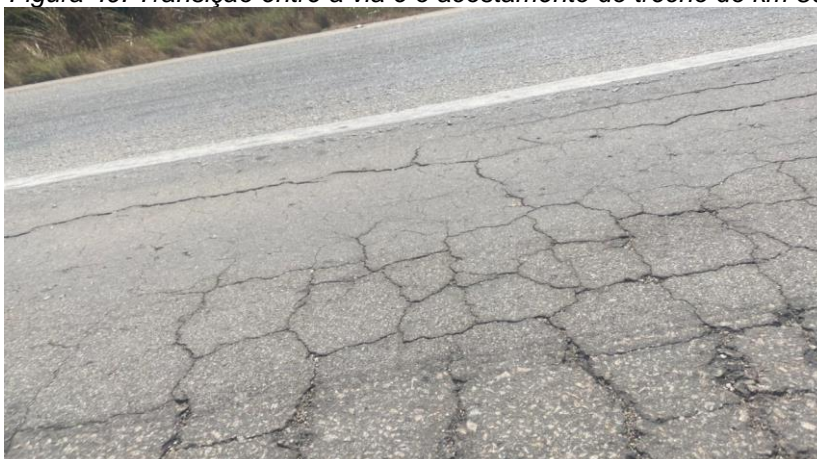
Figura 49: Transição entre a via e o acostamento do trecho do km 80
