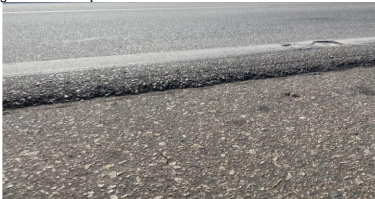
Figura 13: Transição entre a via e o acostamento do trecho do km 53
