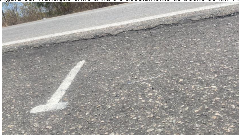
Figura 58: Transição entre a via e o acostamento do trecho do km 112
