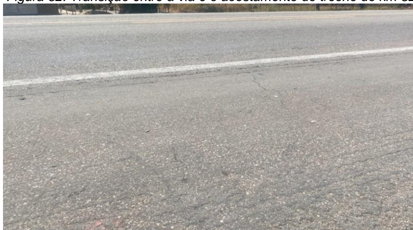
Figura 52: Transição entre a via e o acostamento do trecho do km 82
