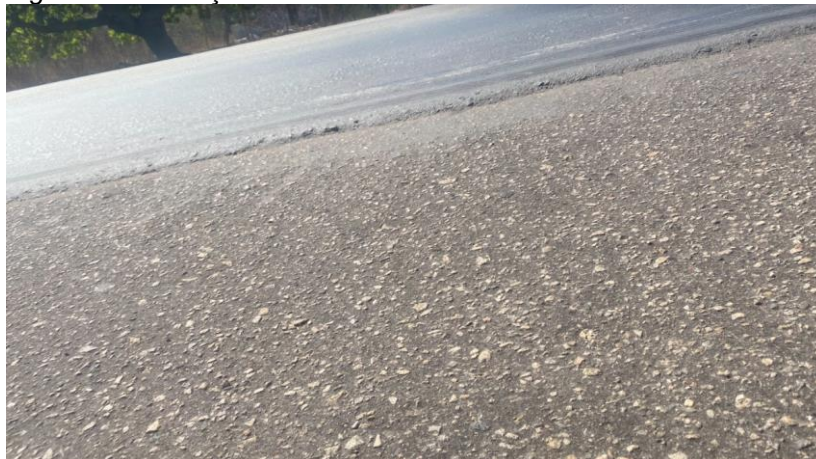
Figura 31: Transição entre a via e o acostamento do trecho do km 64
