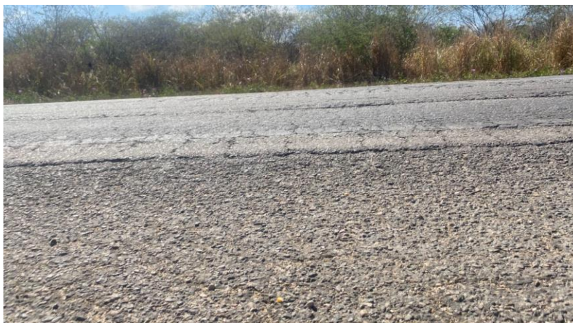
Figura 19: Transição entre a via e o acostamento do trecho do km 55
