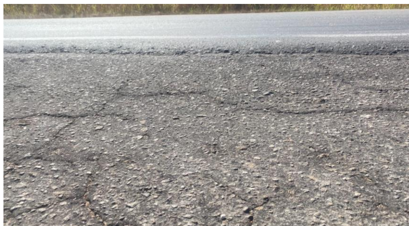
Figura 16: Transição entre a via e o acostamento do trecho do km 54
