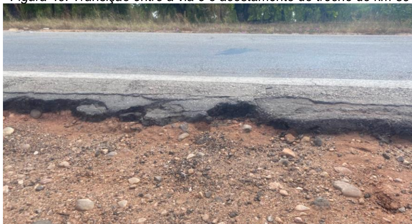
Figura 40: Transição entre a via e o acostamento do trecho do km 69
