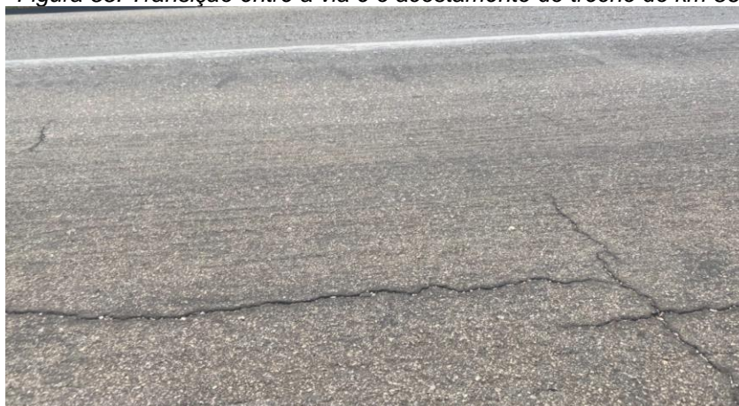
Figura 55: Transição entre a via e o acostamento do trecho do km 86
