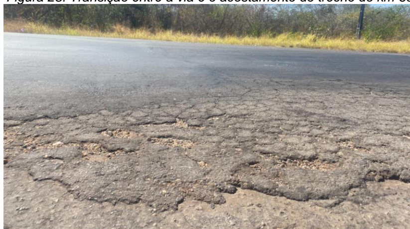
Figura 28: Transição entre a via e o acostamento do trecho do km 63
