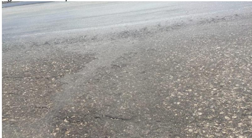
Figura 37: Transição entre a via e o acostamento do trecho do km 67
