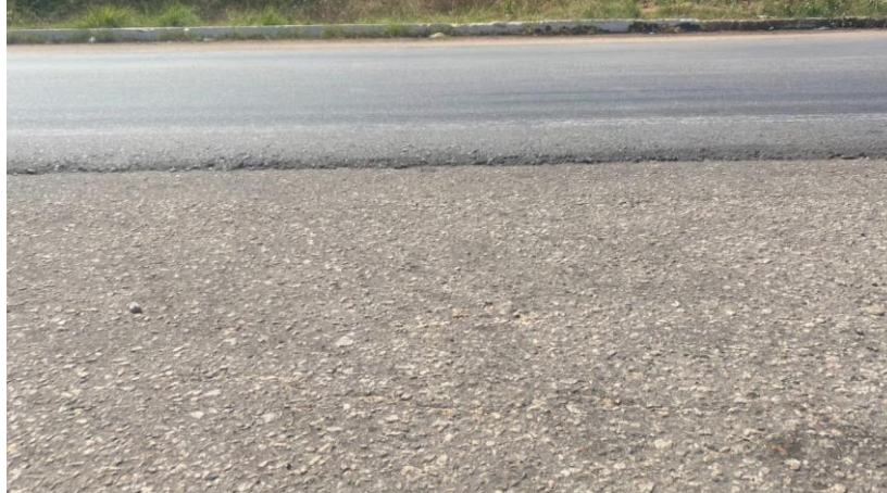
Figura 34: Transição entre a via e o acostamento do trecho do km 65
