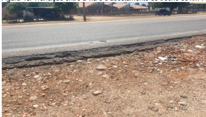
Figura 43: Transição entre a via e o acostamento do trecho do km 70
