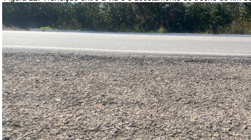
Figura 22: Transição entre a via e o acostamento do trecho do km 59
