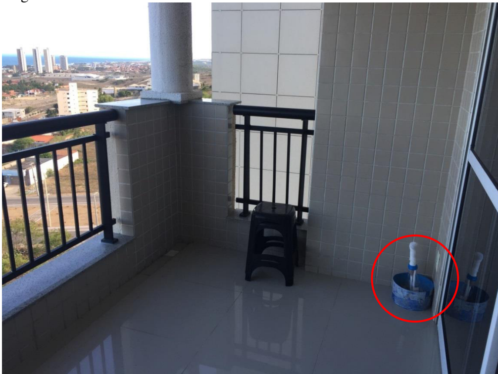
Figura 13 – Vela úmida na sacada do 10º andar.
