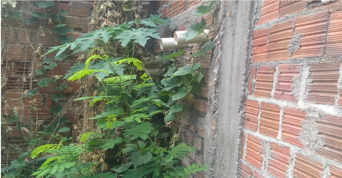
Figura 12- Águas cinzas sendo lançadas no quintal aos fundos do imóvel.
