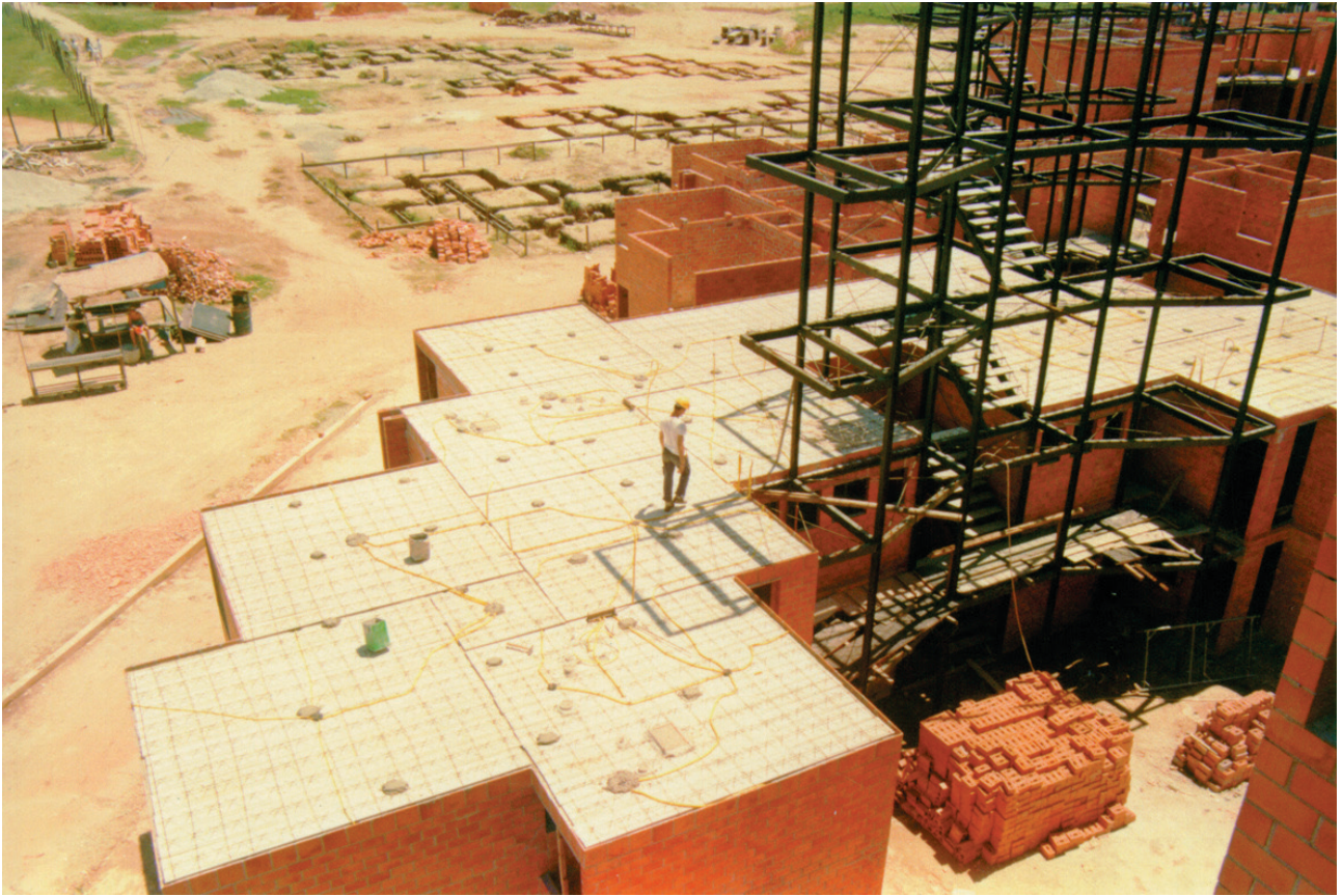
Fig. 1.11: escadas metálicas usadas como prumo das paredes, construídas ao seu redor, no mutirão do COPROMO. Fonte: Acervo da Usina CTAH.
