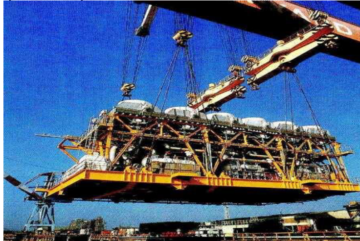
Figura 14 - Exemplo de Sistema de Compressão para plataforma próxima a Mumbai, na Índia
