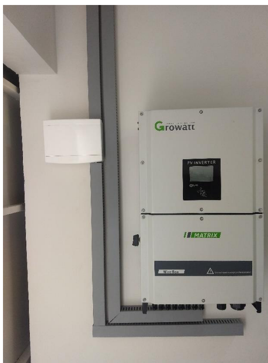
Figura 10 – Inversor string instalado.
