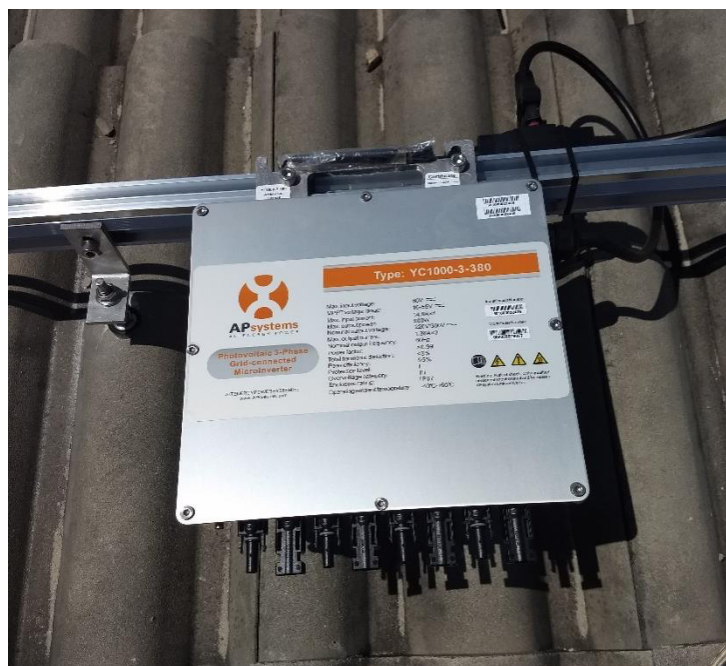
Figura 11 – Microinversor instalado em um telhado
