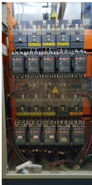
Figura 42 – Painel elétrico de 480 V.
