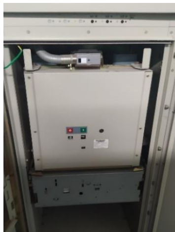
Figura 41 – Disjuntor de proteção de circuito em 6,9 kV dentro do cubículo blindado.
