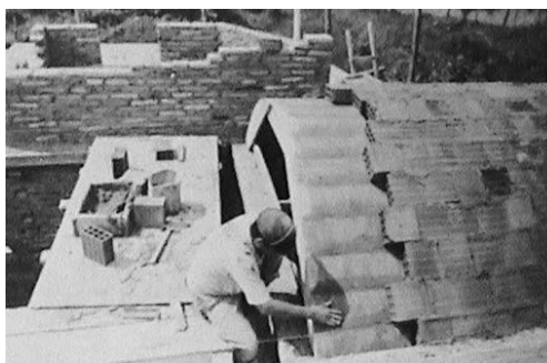
Canteiro de obras da Residência do arquiteto Paulo Cardoso, construção das abobadas Fonte_ Acervo do arquiteto Paulo Cardoso.
