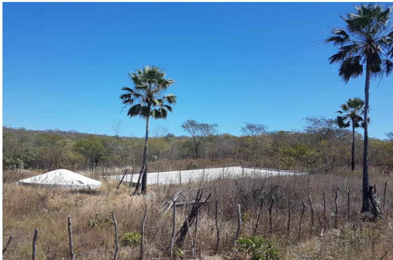
Figura 3. Cisterna Calçadão construída no Assentamento – Via P1+2.
