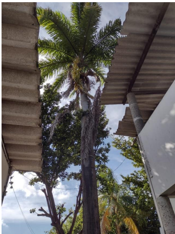
Figura 13 - Risco a edificações. Queda de galhos
