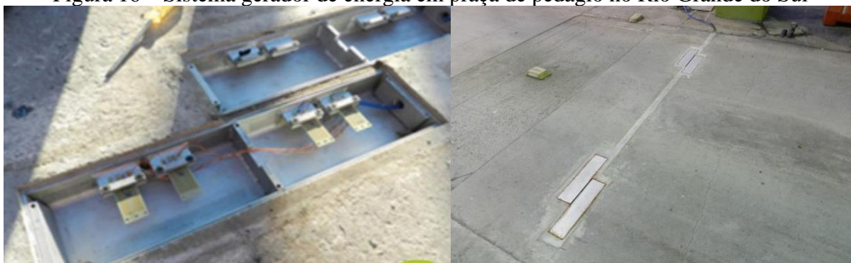
Figura 16 – Sistema gerador de energia em praça de pedágio no Rio Grande do Sul
