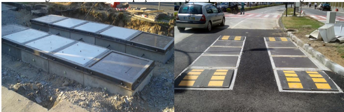
Figura 13 – Sistema de captação de energia implantado em via de Portugal
