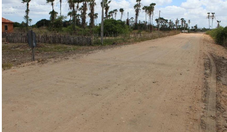
Figura 25 - Depressão na via causada pela acomodação do solo.
