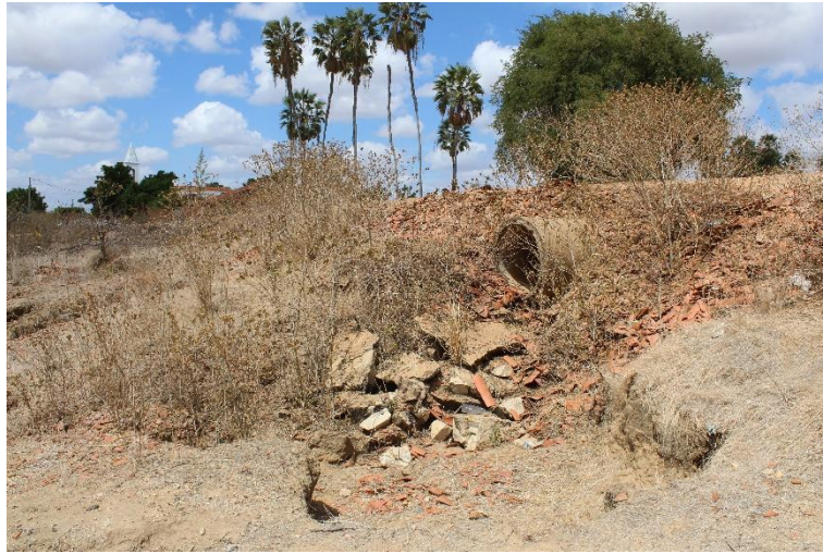
Figura 21 - Bueiro ocasionando graves erosões na lateral da estrada.
