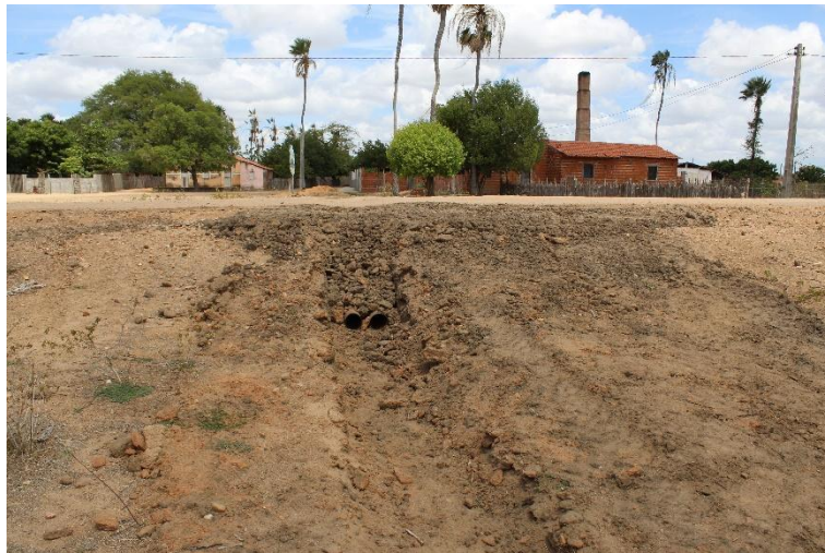
Figura 24 - Bueiro executado por morador sem posterior compactação do solo.
