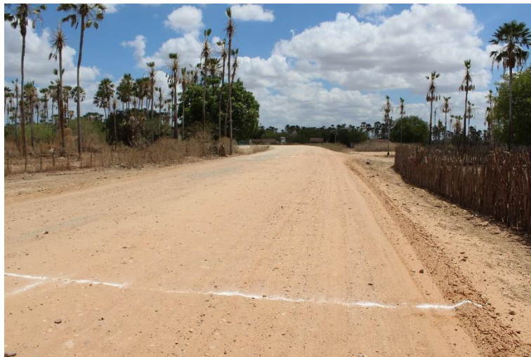
Figura 32 - Segregação de agregados finos na via.
