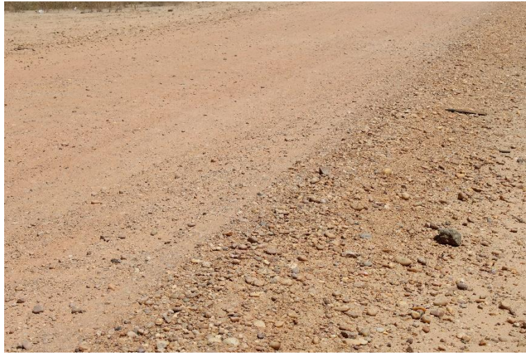
Figura 31 - Segregação de agregados grossos na via.
