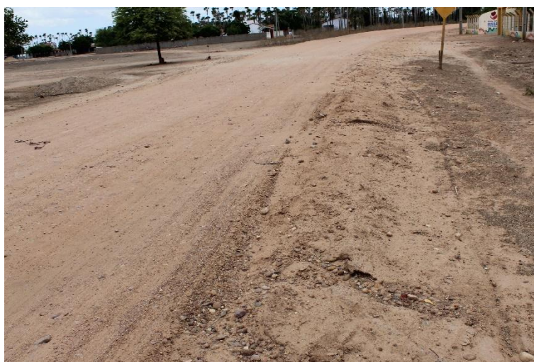
Figura 20 - Erosões nas laterais da via devido à falta de drenagem e a seção transversal imprópria.
