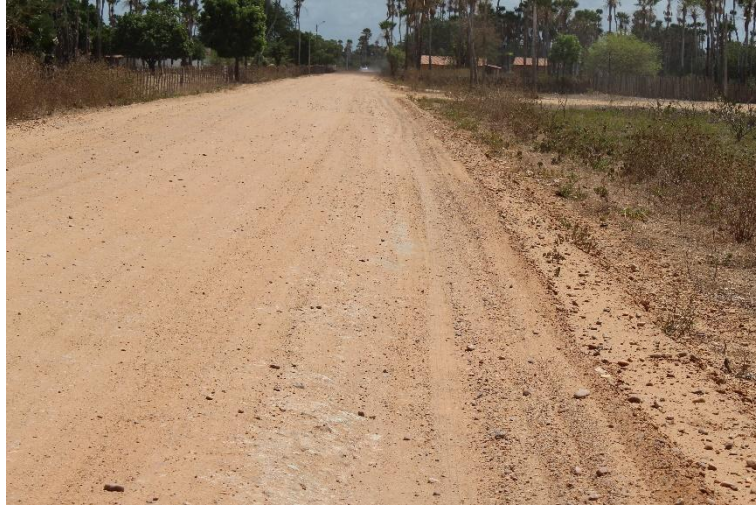
Figura 30 - Afundamento de trilhos de roda.
