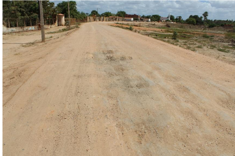
Figura 29 - Presença de buracos na via.
