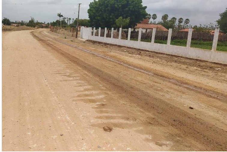
Figura 27 - Buracos na via devido a rega para minimizar a poeira.
