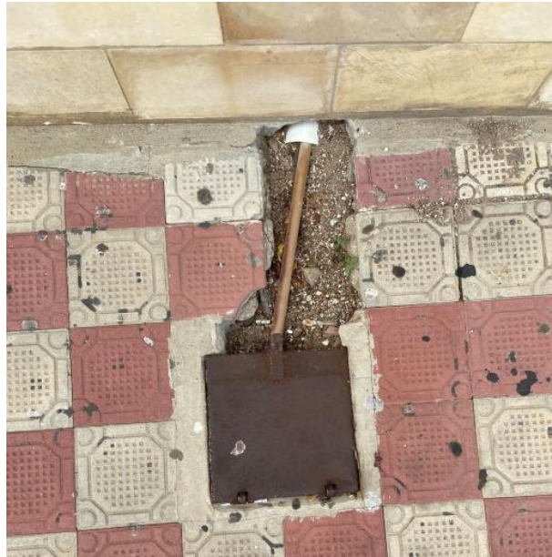
Figura 85 – Buraco na calçada
