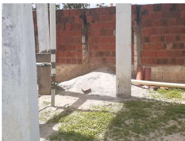
Figura 8 – Depósito de areia retirado do reservatório
