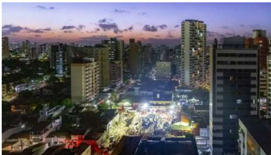
Figura 8 - Foto do local do desabamento do edificio Residencial Andrea no Dionísio Torres.
