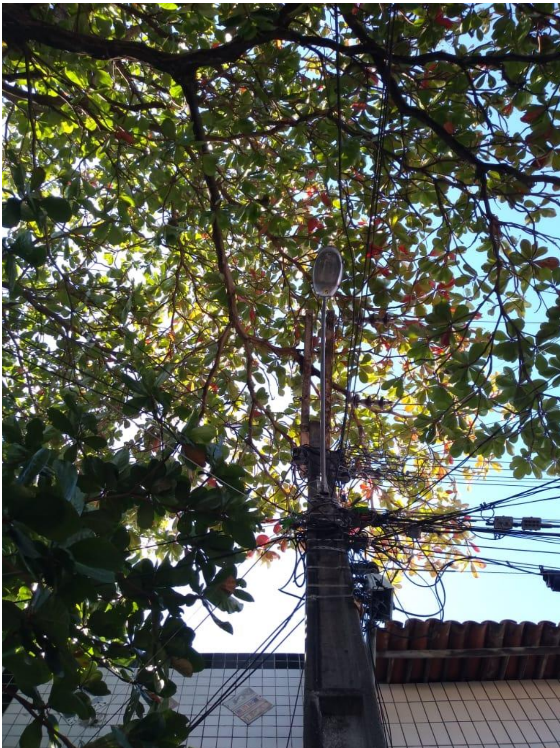
Figura 11: Avaliação de árvore comprometendo as instalações. Fonte: Miller Clementino (2020)
