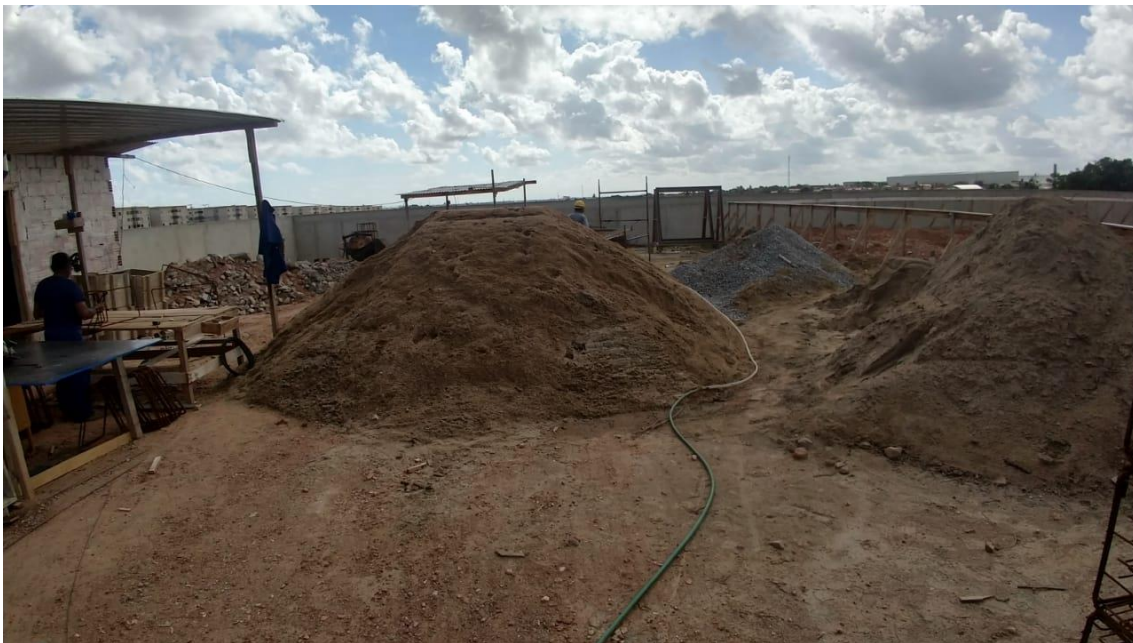
Figura 7 – Canteiro de obras sem baias de agregados
