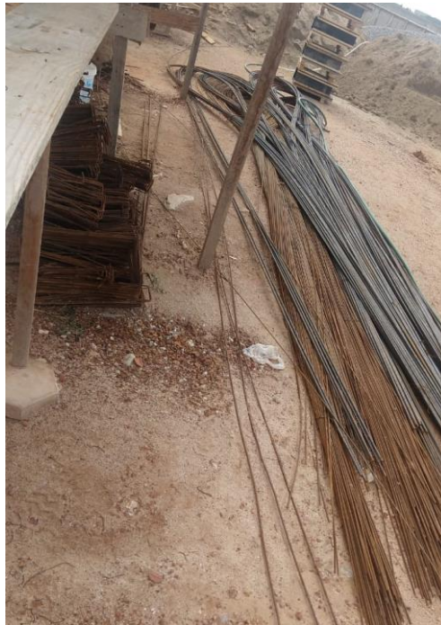
Figura 8 – Aço armazenado de maneira incorreta.
