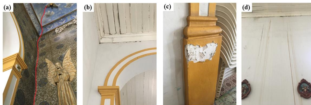
Figura 5. Manifestações patológicas internas na Igreja de Nossa Senhora do Rosário: (a) trinca, (b) desagregação do forro, (c) destacamento e (d) manchas úmidas.
