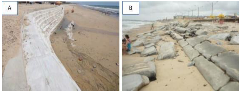
Figura 4 – A) Bagwall construído na praia do ícarai ; B) Bagwall destruído pelo impacto do mar.
