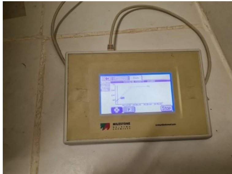
Figura 13 – Interface do painel programável do biodigestor.
