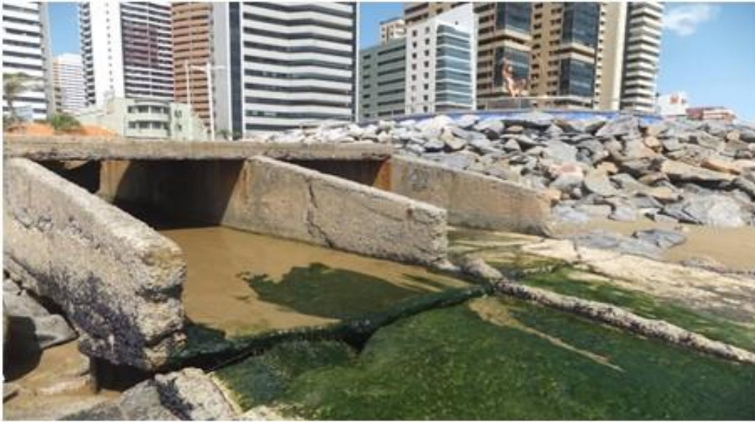
Figura 10: Drenagem pluvial com má aparência e indícios de odor de efluentes.
