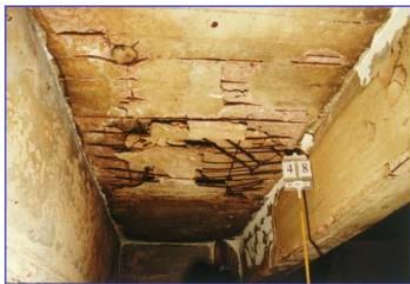
Figura 1 – Efeito do spalling nas lajes de concreto armado do cinema Cacique em Porto Alegre em 1996
