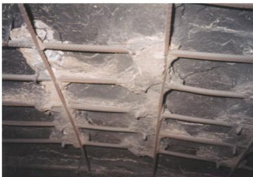
Figura 2 – Anéis de concreto do Channel Tunnel destruídos por lascamentos térmicos explosivos nos primeiros minutos de incêndio em 1996
