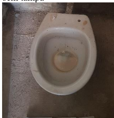
Figura 18 - Bacia sanitária sem tampa
