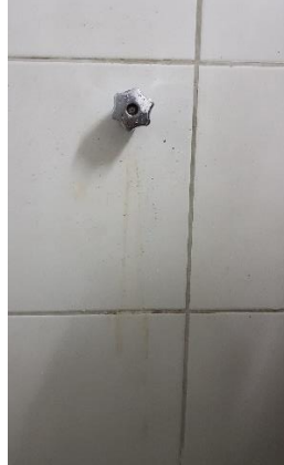
Figura 11 - Registro com vazamento
