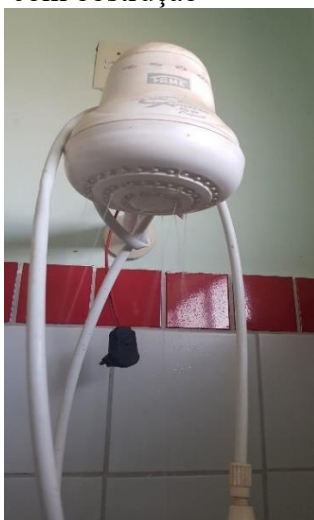
Figura 28 - Ducha apresentando orifícios com obstrução com obstrução
