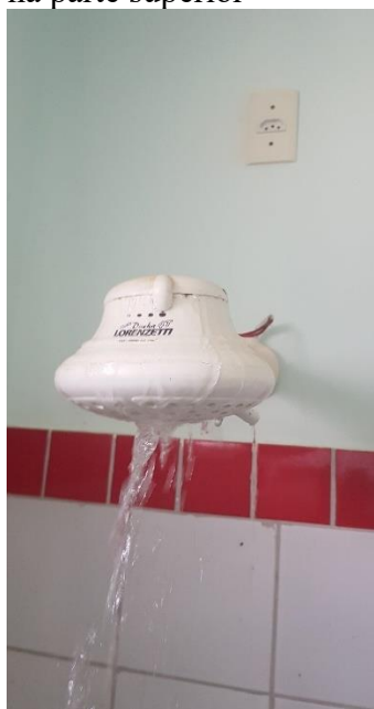
Figura 29 - Ducha apresentando vazamento na parte superior
