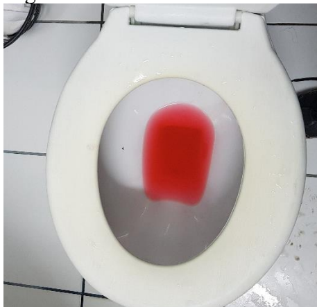
Figura 13 - Bacia com vazamento
