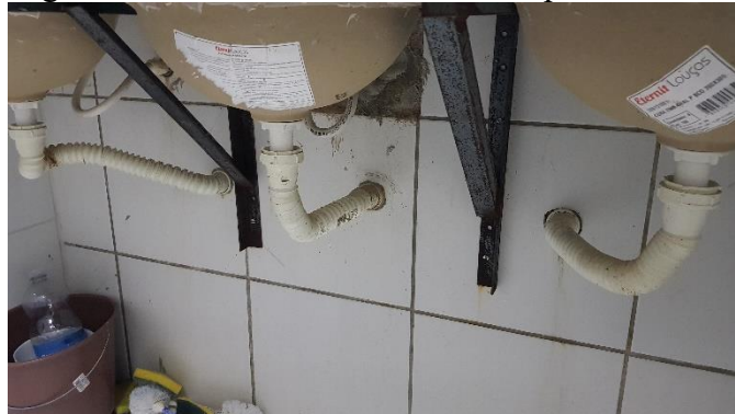
Figura 10 - Lavatórios com sifão mal posicionado
