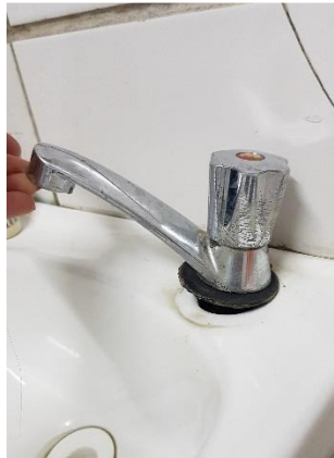
Figura 12 - Torneira mal fixada e com vazamento
