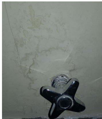
Figura 21 - Registro com vazamento
