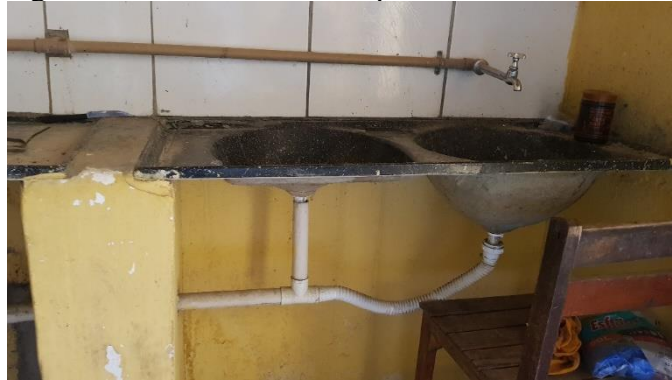
Figura 9 - Pia com sifão mal posicionado
