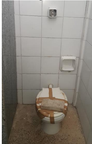
Figura 26 - Bacia interditada por ineficiência da válvula de descarga
