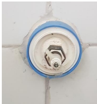
Figura 27 - Válvula de descarga quebrada
