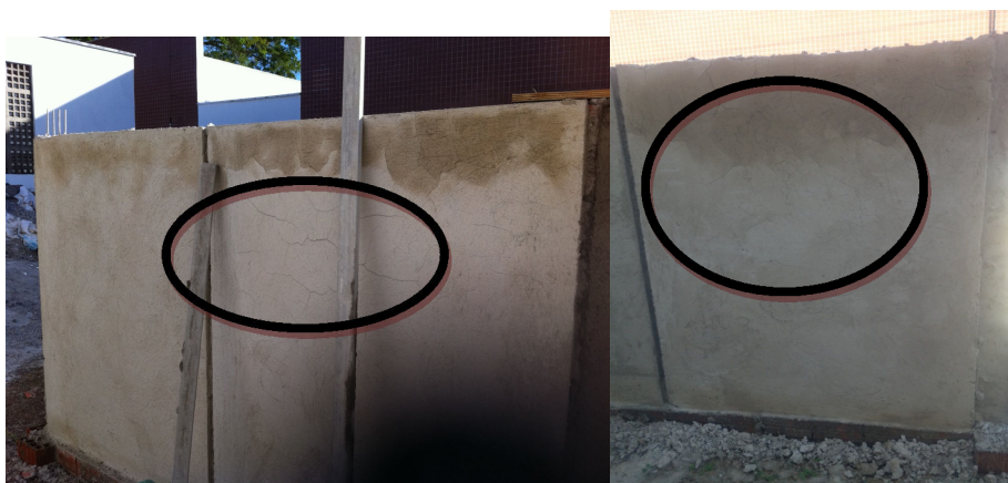
Figura10 - Fissura em painéis com traço de substituição de 50% e 75%.
