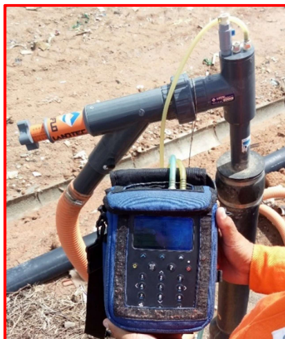
Figura 6. Vista do cabeçote do dreno horizontal conectado ao leitor de gás GEM5000
