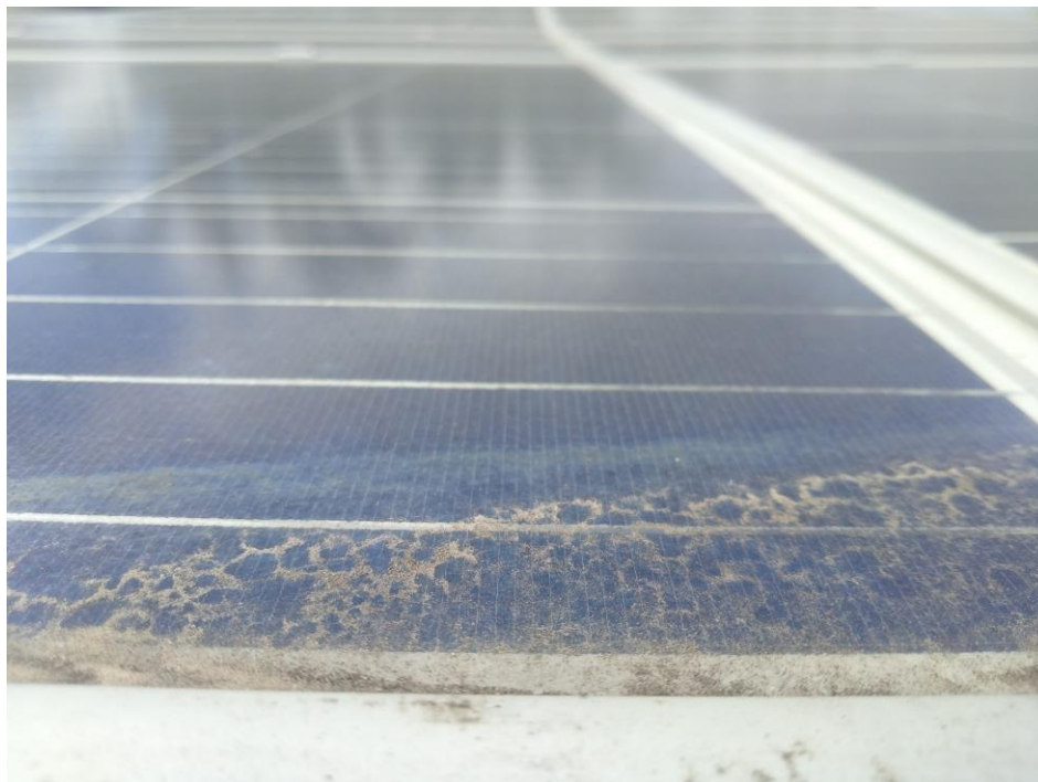
Figura 3 – Sujidade encontrada nos módulos FV da planta2.
