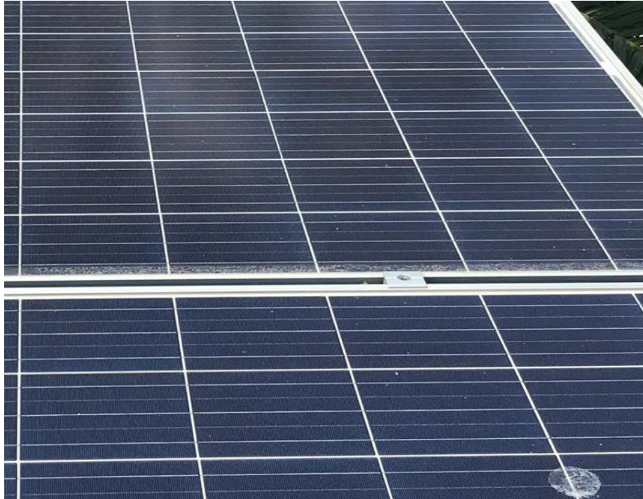
Figura 2 – Sujidade encontrada nos módulos FV da planta1.
