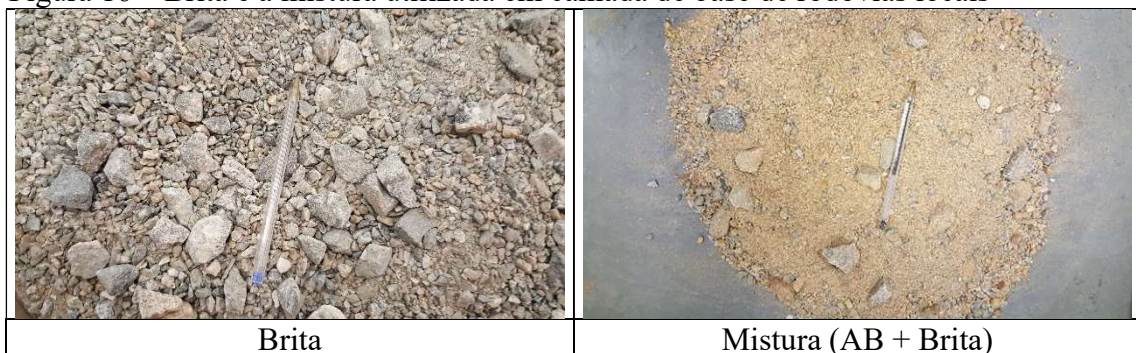
Figura 16 – Brita e a mistura utilizada em camada de base de rodovias locais
