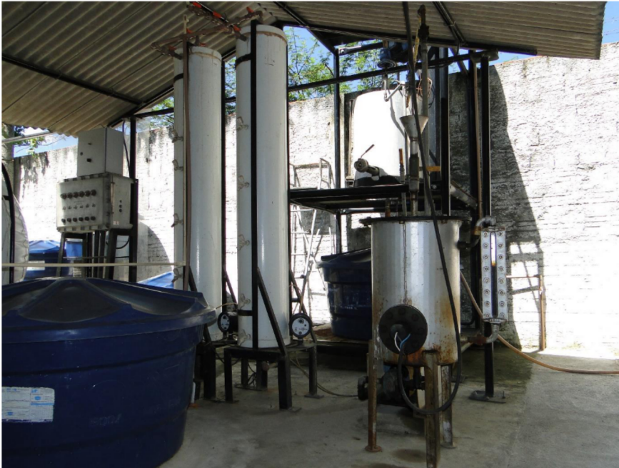
Figura 3. 6 Reatores anaeróbios do tipo UASB com o sistema de bombeamento.
