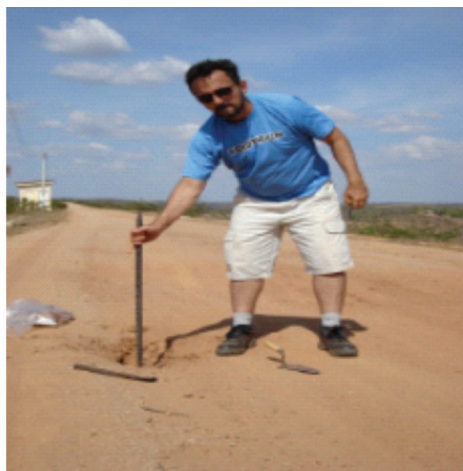
Figura 5 - Buracos no coroamento
