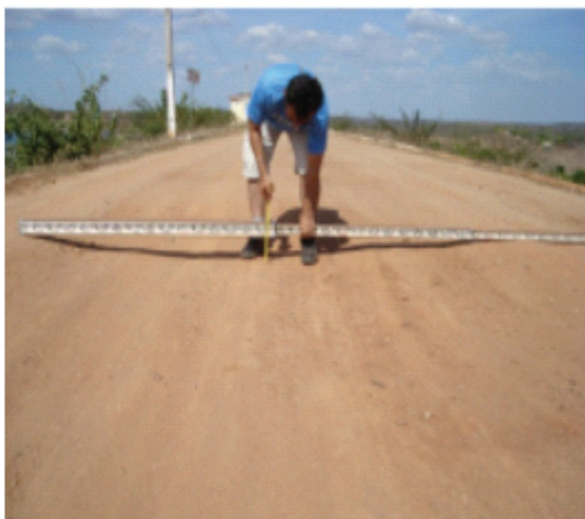
Figura 4 - Afundamento no coroamento
