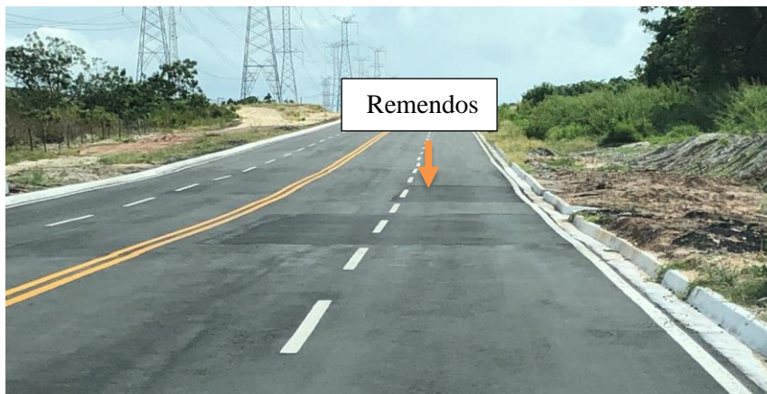
Figura 9: Presença de um remendo de grande extensão no segmento 10 das faixas F1 e F2
