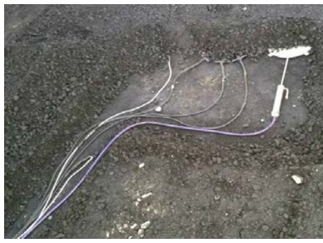
f) Instrumentação sob revestimento
