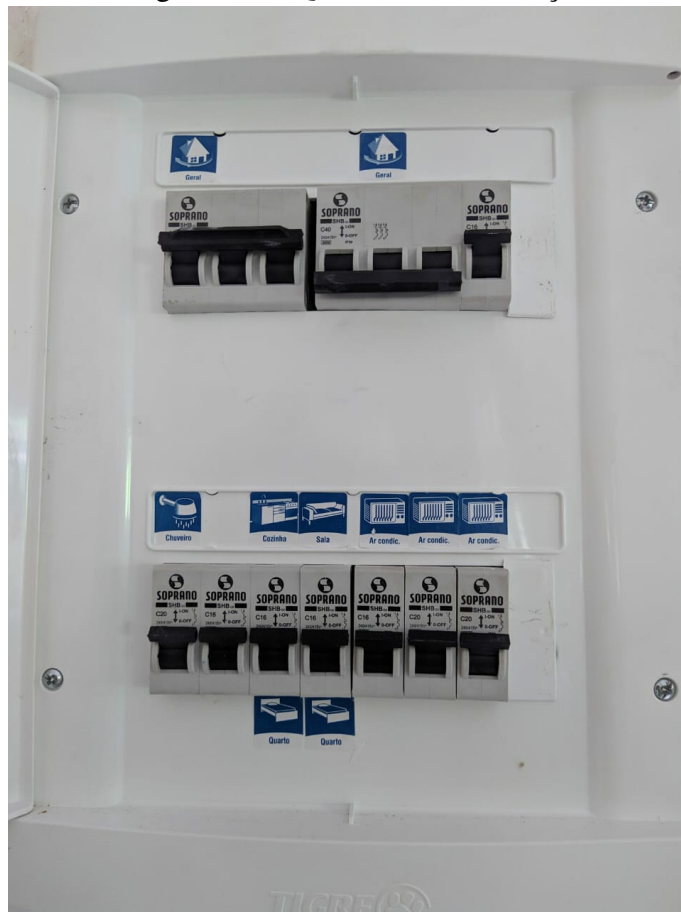
Figura 31 – Quadro de Distribuição
