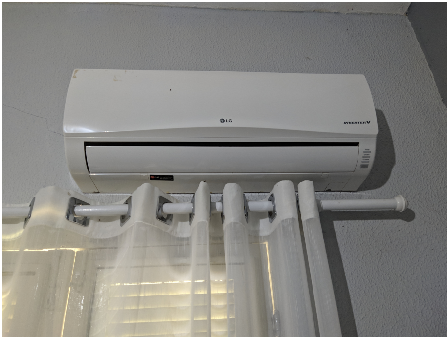
Figura 34 – Modelo de Ar Condicionado da Residência Analisada
