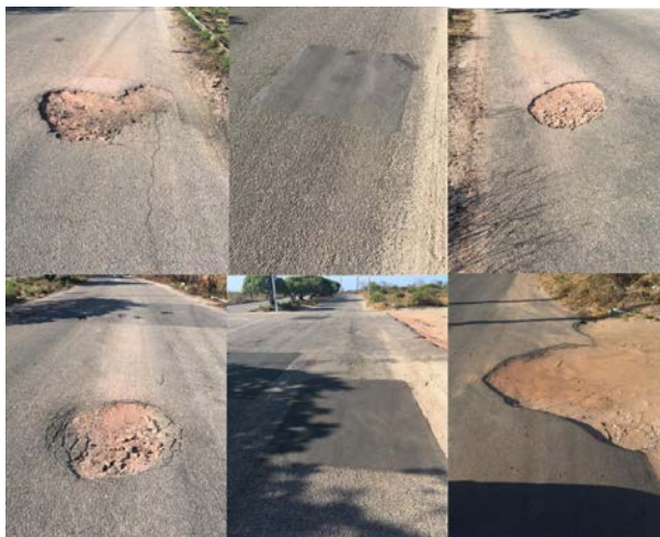
Figura 3 - Defeitos encontrados via estudada.
