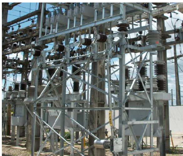
Figura 2 – Banco de Capacitor
