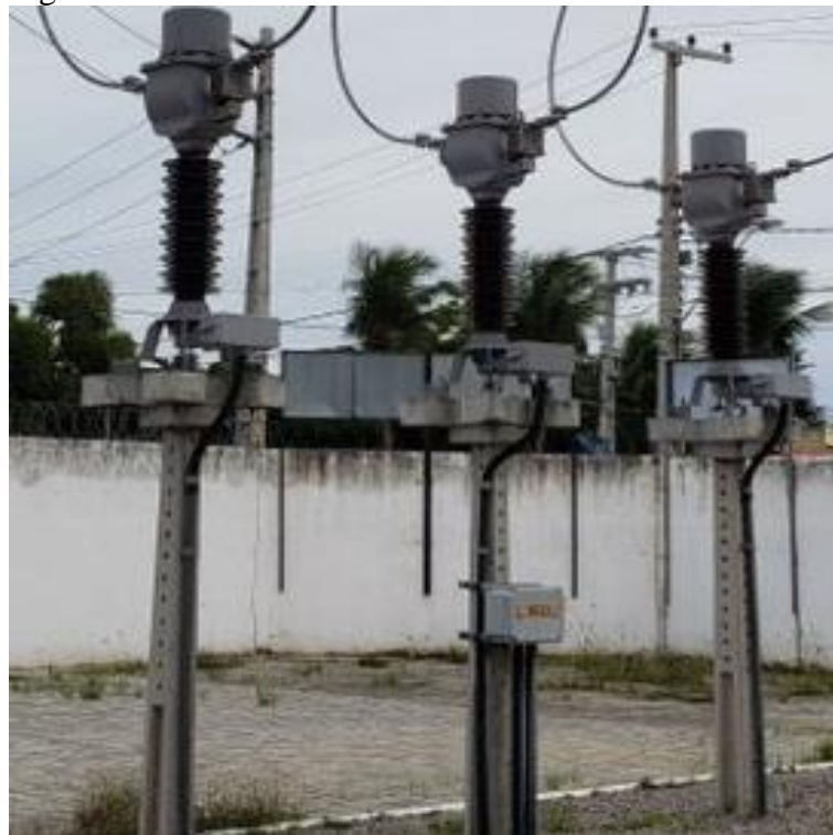
Figura 21 – Transformador de corrente alta tensão
