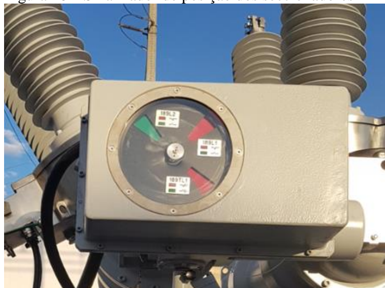
Figura 26 – Sinalizador de posição dos seccionadores
