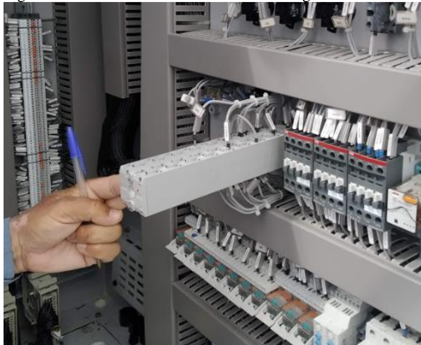
Figura 29 – Parte interna da chave seletora original de fábrica
