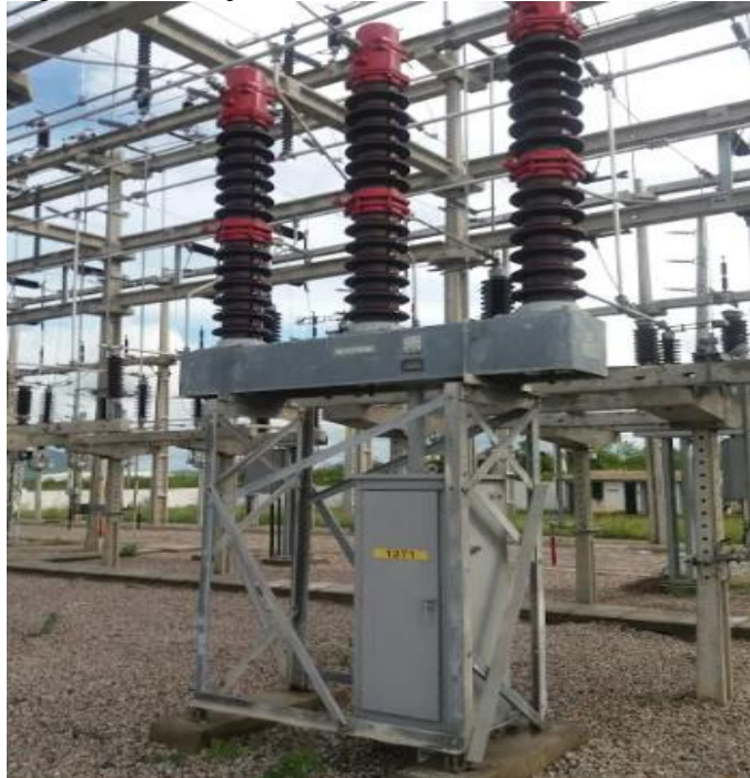
Figura 13 – Disjuntor alta tensão PVO
