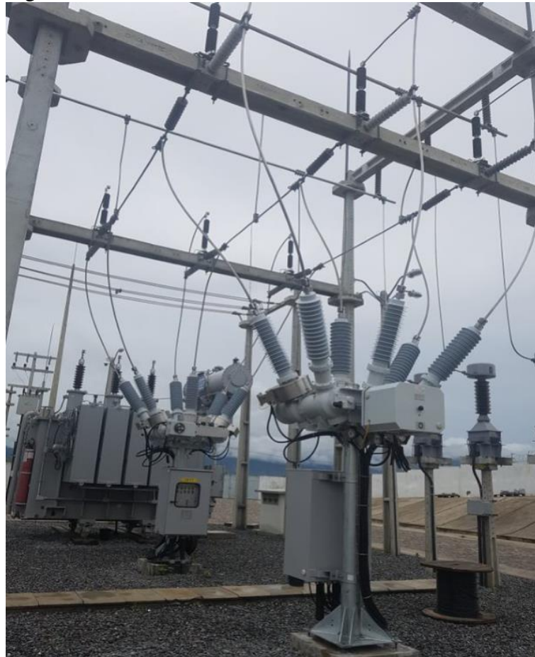
Figura 24 – Módulo híbrido instalado
