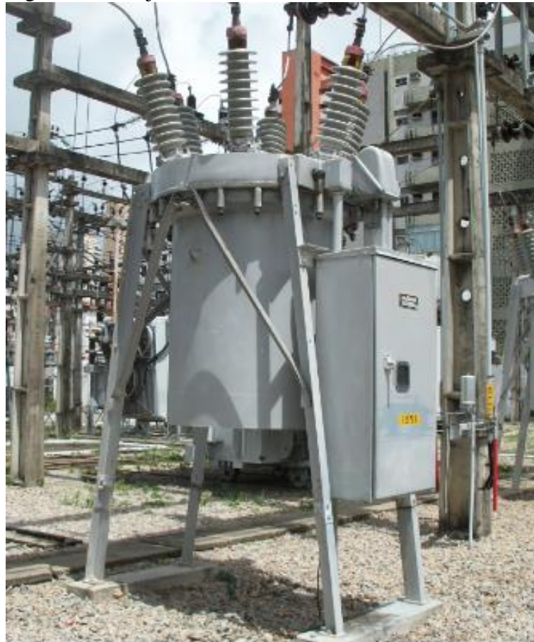
Figura 12 – Disjuntor alta tensão GVO
