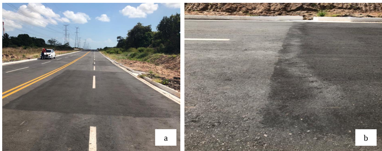
Figura 6: Vista geral da parte de menor cota e presença de remendo
