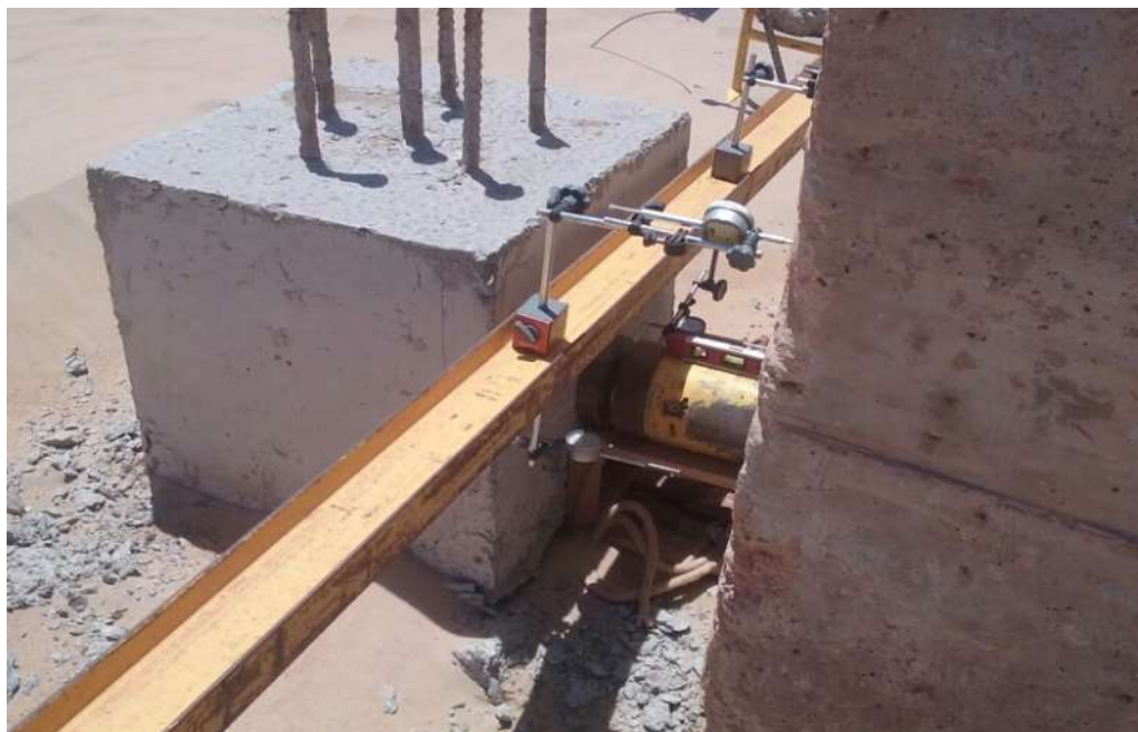
Figura 31 - Sistema de medição montado in loco
