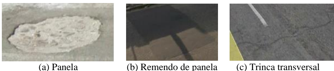
Figura 2: Detecção de defeitos em pavimentos rodoviários pelo Google Earth (Fonte: Ferreira e Castelo Branco, 2016)
