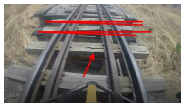
(b) Severidade 1: Dormentes deslocados e dormente rachado
