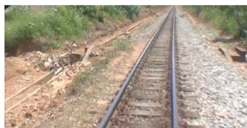
(b) Necessidade de aceiro e limpeza de sistema de drenagem
