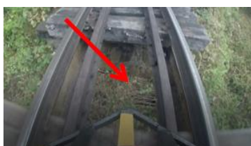
(c) Severidade 2: Dormentes faltando
