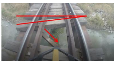
(e) Severidade 4: Dormentes rachados, deslocados e faltando
