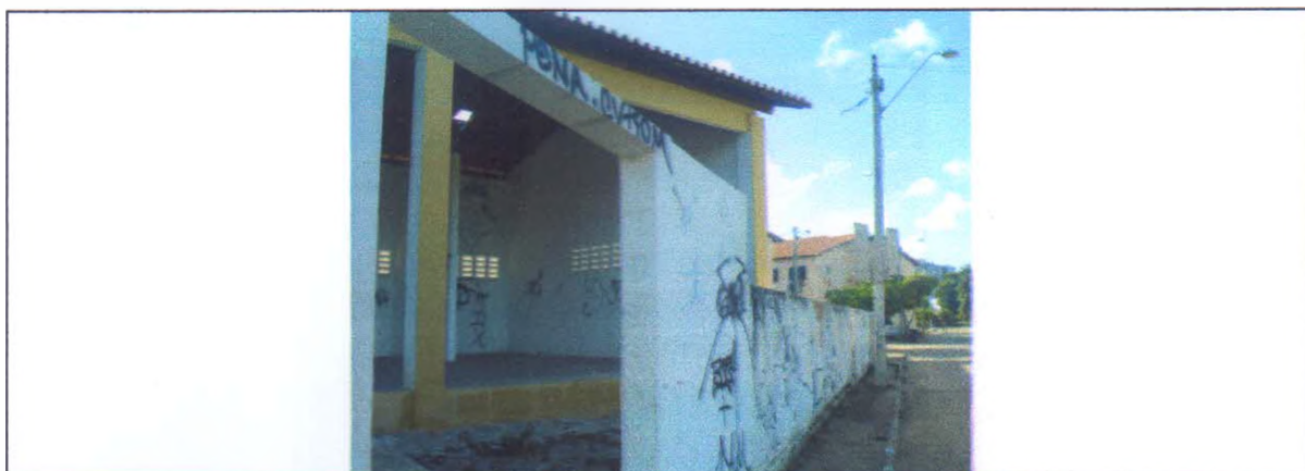
FIGURA 4 – Vista frontal do galpão construído para sediar a Associação dos Catadores de Recicláveis da Maravilha
