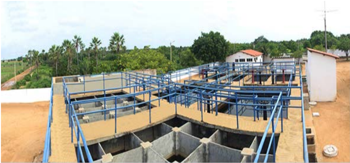
Figura 1 - Estação de Tratamento de Água do município de Limoeiro do Norte Fonte: SAAE
