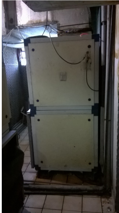
Figura 6: Unidade evaporadora da UTI Pediátrica e Neonatal.
