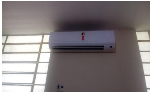
Figura A7: Ar condicionado modelo novo em uso.
