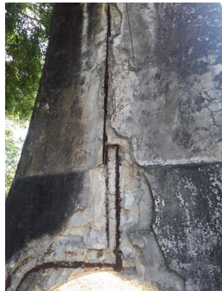
Figura A30: Encanamentos de ferro desgastados.
