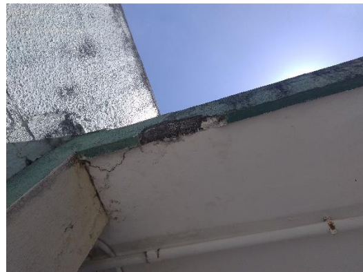
Figura A10: Parede de uma entrada em degradação evidente.
