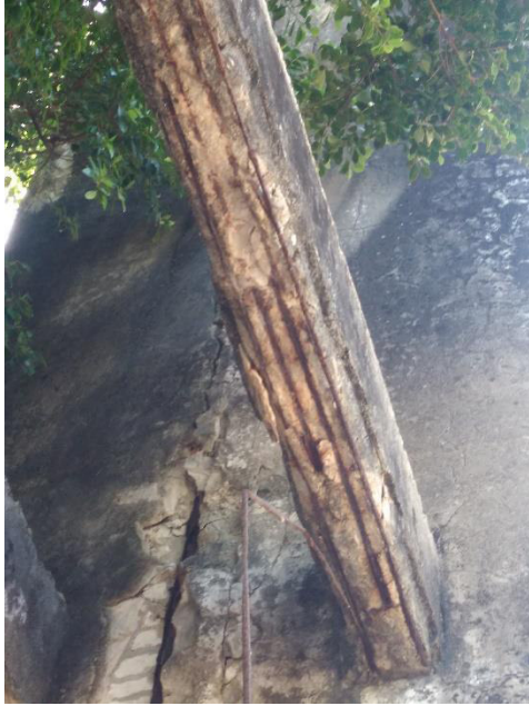
Figura A27: Viga com armadura exposta.
