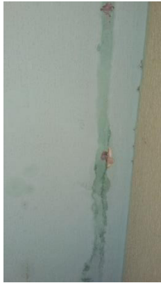
Figura A11: Parede sob efeitos de umidade devido ao ar condicionado.
