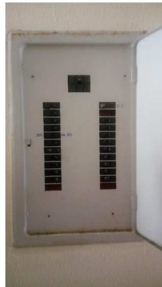
Figura A4: Quadro de disjuntores
