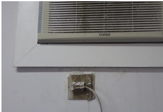
Figura A13: Inadequação de um sistema.
