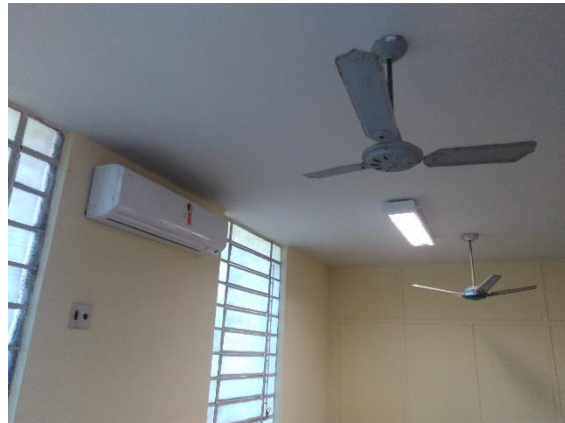
Figura A8: Ventiladores antigos em sala e sem uso.
