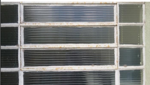
Figura A15: Esquadrias enferrujadas pelo lado de fora da edificação.
