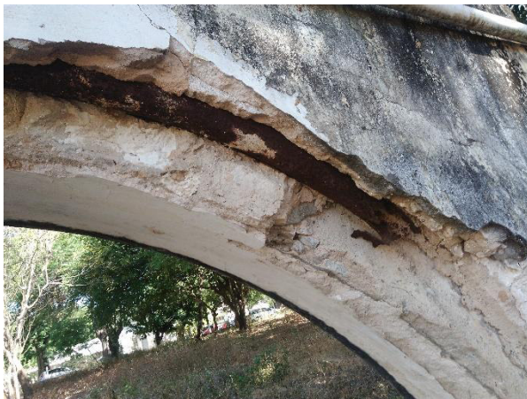
Figura A29: Encanamento de ferro deteriorado.
