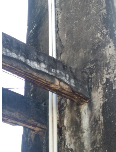
Figura A28: Rachadura na estrutura.
