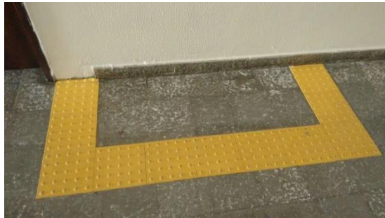
Figura A25: Sinalização térrea da localização dos extintores.
