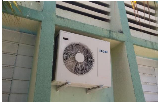
Figura A12: Vista externa do motor do ar condicionado.
