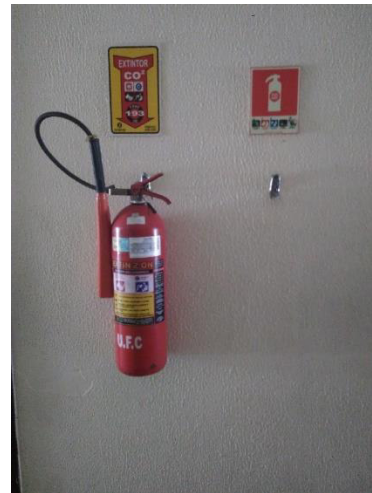
Figura A26: Localização dos extintores e ausência de um equipamento.
