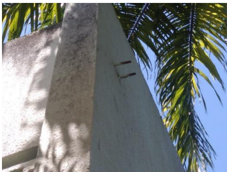
Figura A9: Peças metálicas enferrujadas e anexas desde a construção.
