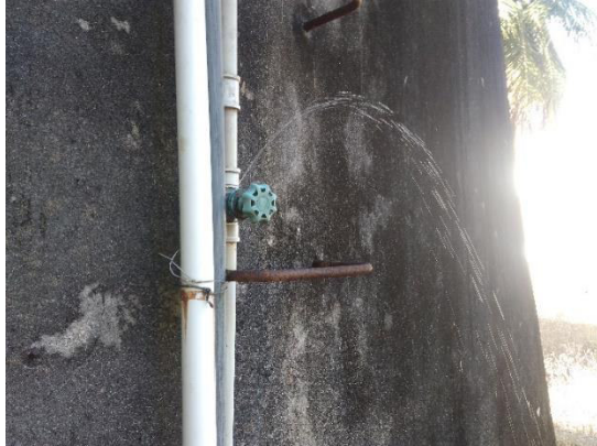
Figura A31: Vazamento na tubulação.
