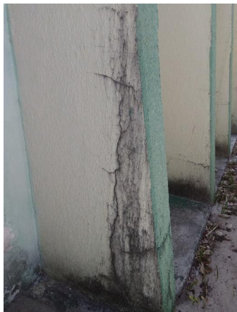
Figura A16: Rachadura em estrutura da edificação.
