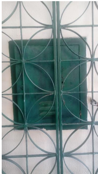
Figura A3: Quadro de distribuição.
