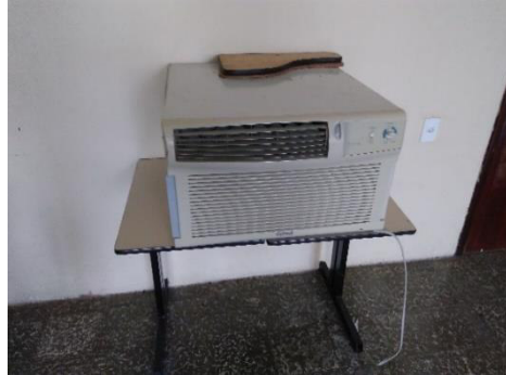
Figura A2: Ar condicionado sem uso.
