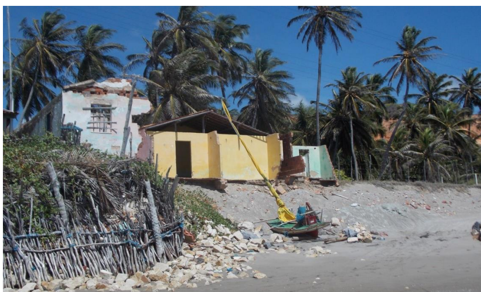
Figura 8 – Casas derrubadas pelo avanço do mar em Barreiras de Baixo, vestígios da erosão costeira.
